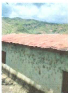
FOTO No. 3. CUBIERTA DE LÁMINA. Suustrucción de cubierta de lámina en mal estado por lámina troquelada
